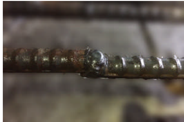
挿入マーク施工不良 (30mm)
