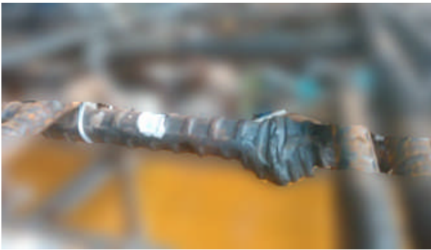
グラウト充填不足
