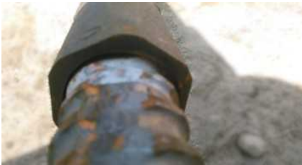
グラウト材充填不足
