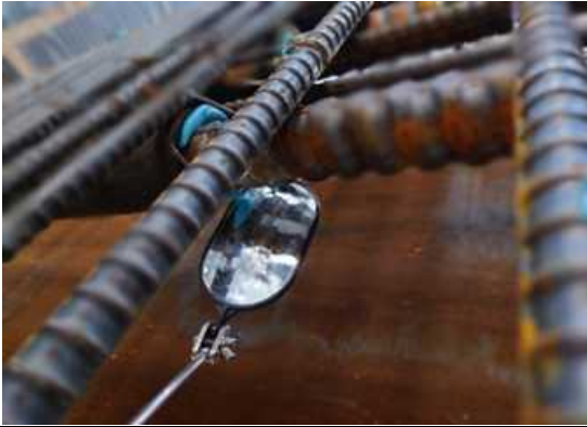
グラウト材充填不足
